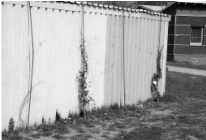
Auf dem Weg zu einer grünen Oase: Die Gerätehütte neben dem Park-Haus.
